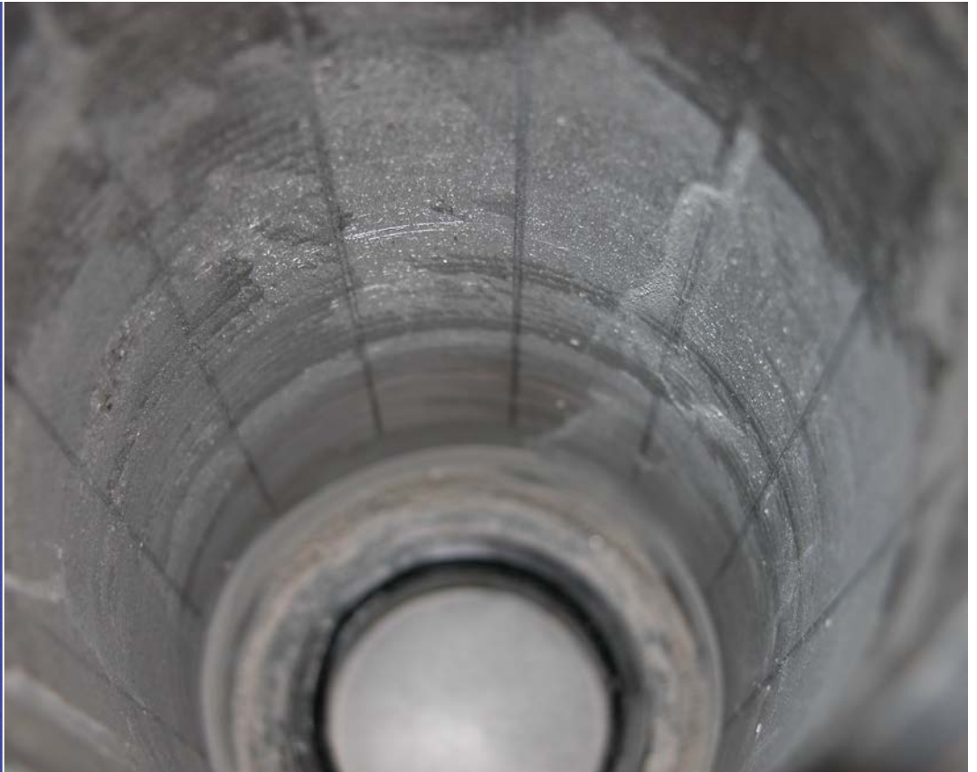
Acumulación extrema de escamas en la pared del evaporador
